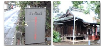
＜松庵稲荷に設置したスタンドパイプ＞
